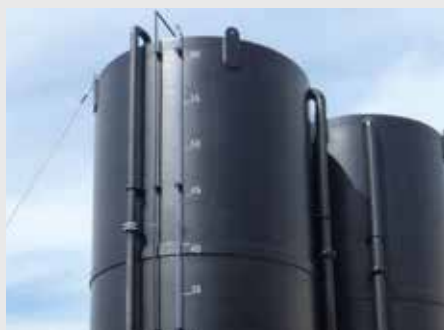
Depósitos de almacenamiento de polietileno
